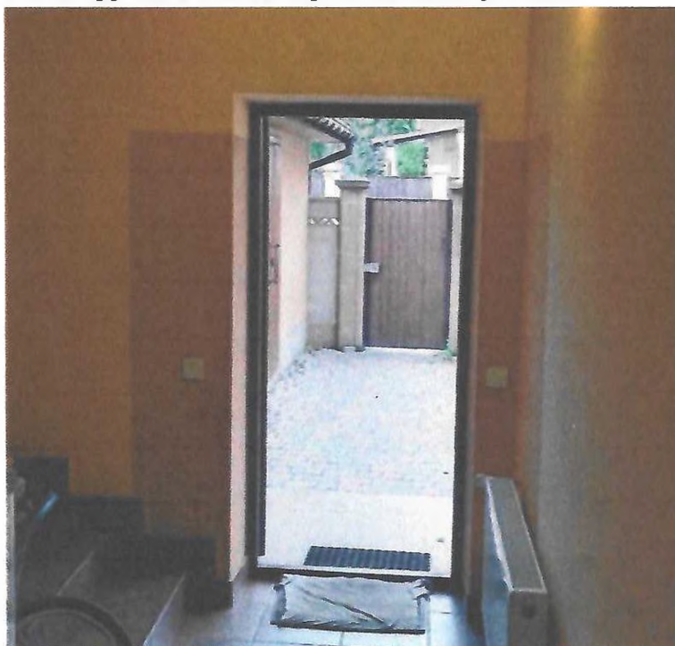
Фото №3. Вхідні двері до гуртожитку встановлені без порогу
